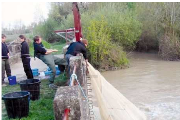
Au portes à flot d'Arcins, la mise en place d'un filet servira à faire des relevés sur la migration des poissons. PHOTO J.-C. R.
