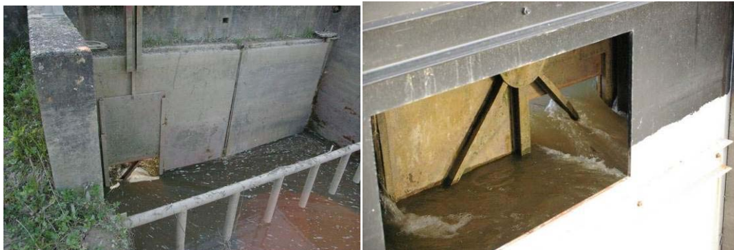
Figure 42 : Vantelle ouverte sur les portes à flot d'Issan, vue de l'aval et de l'amont.
