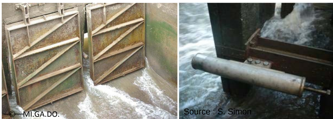
Figure 40 : Raidisseurs installés sur les clapets de la jalle du Breuil. Source : MIGADO et S. Simon, 2010
