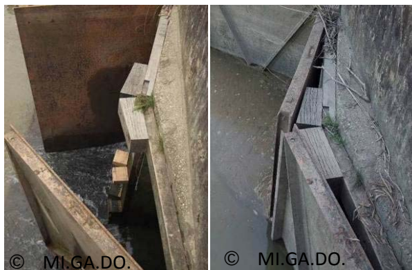
Figure 38 : Des cales en chêne au niveau des portes à flot d'Arcins, à marée basse (portes à flot ouvertes) et à marée montante (portes à flot fermées laissant une ouverture de 10 cm sur toute la hauteur).
