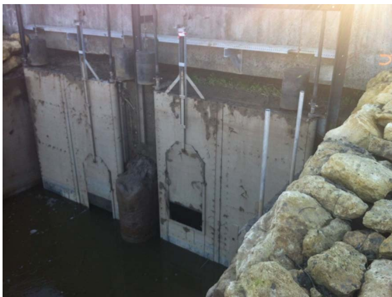
Figure 46 : Porte à flot de Despartins aménagée avec une vanne haute et une vanne basse.
