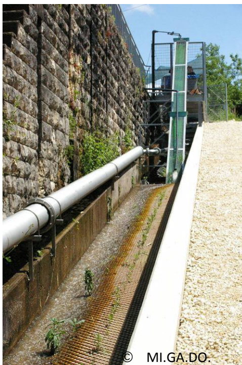
Figure 15 : Passe à anguilles installée sur le site de Tuilières en 2010.
