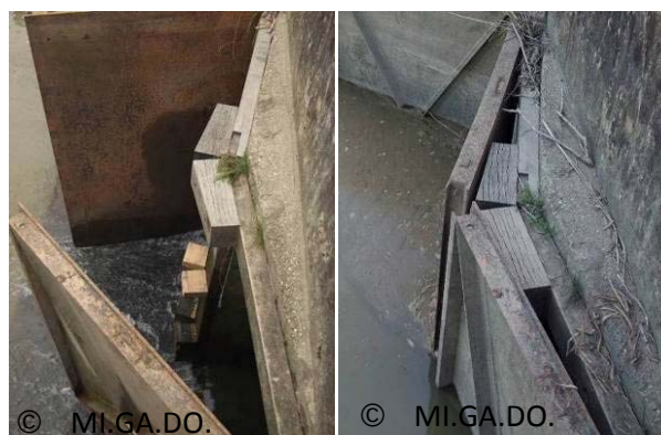
Figure 55 : Des cales en chêne au niveau des portes à flot d'Arcins, à marée basse (portes à flot ouvertes) et à marée montante (portes à flot fermées laissant une ouverture de 10 cm sur toute la hauteur).
