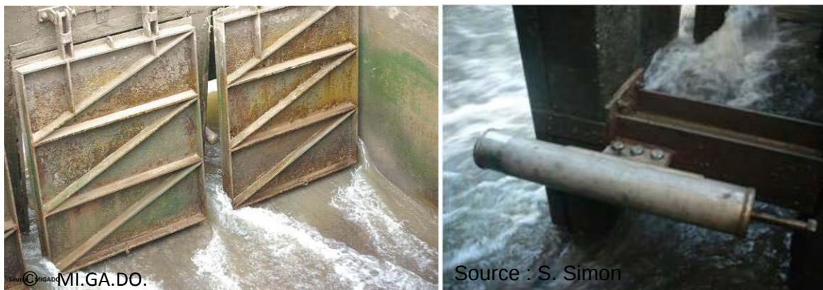
Figure 57 : Raidisseurs installés sur les clapets de la jalle du Breuil. Source : MIGADO et S. Simon, 2010
