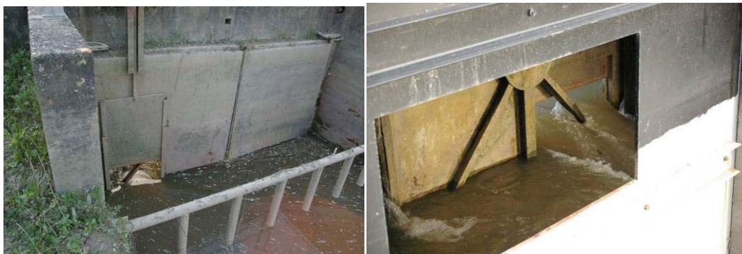
Figure 59 : Vantelle ouverte sur les portes à flot d'Issan, vue de l'aval et de l'amont.
