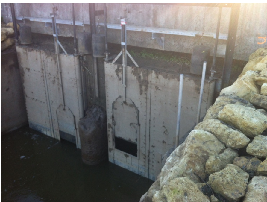
Figure 63 : Porte à flot de Despartins aménagée avec une vanne haute et une vanne basse.
