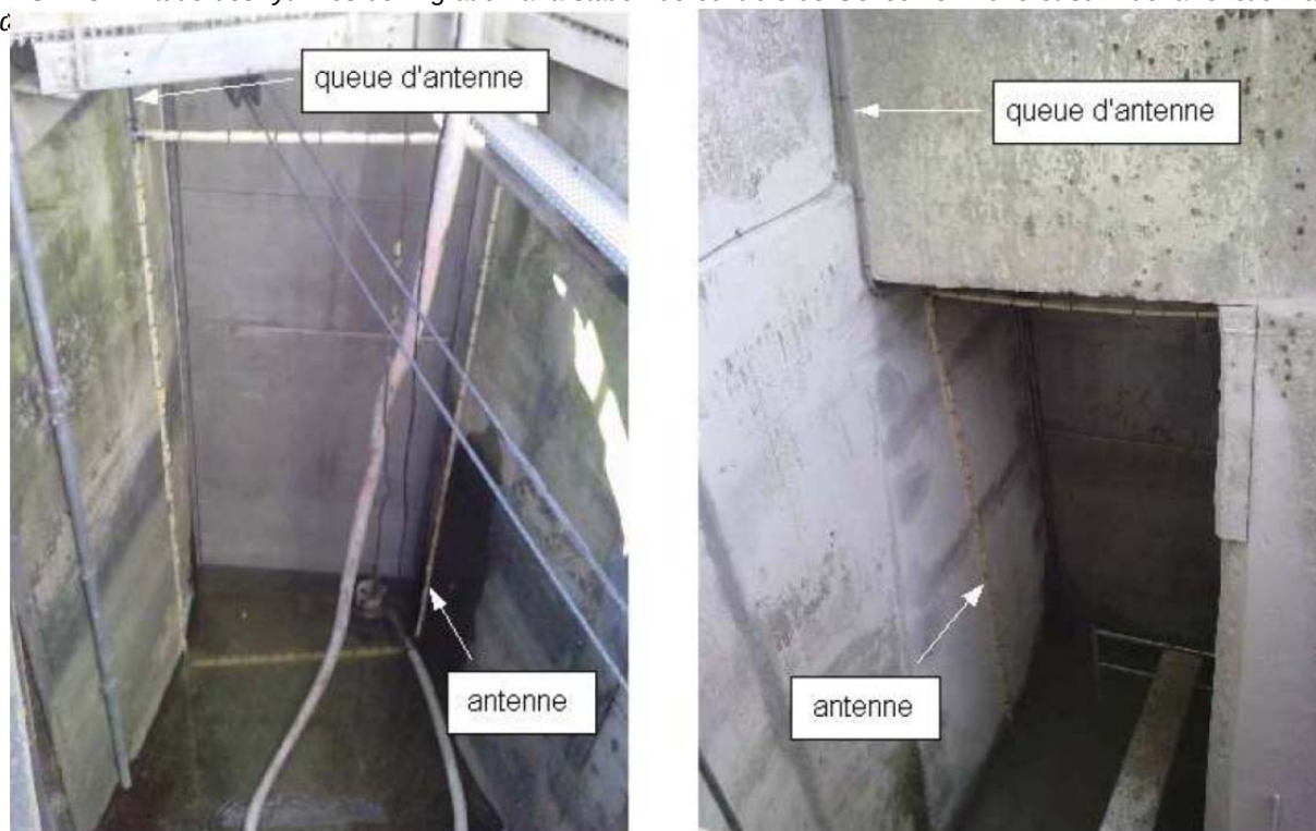
Figure 10 : Vue des antennes 1 (à gauche) et 2 (à droite) installées à Golfech en 2012 au niveau des entrées de l'ascenseur à poissons.
