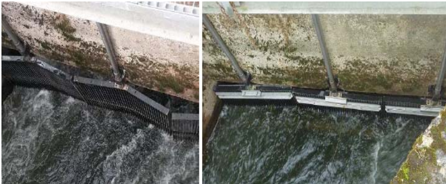
Figure 2 : Photos des grilles pivotantes de Mauzac détériorées (à gauche) et réparées provisoirement (à droite), (Photos MIGADO, ECOGEA)
