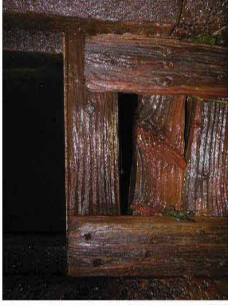
Exemple de seuils interbassins en bois à changer
