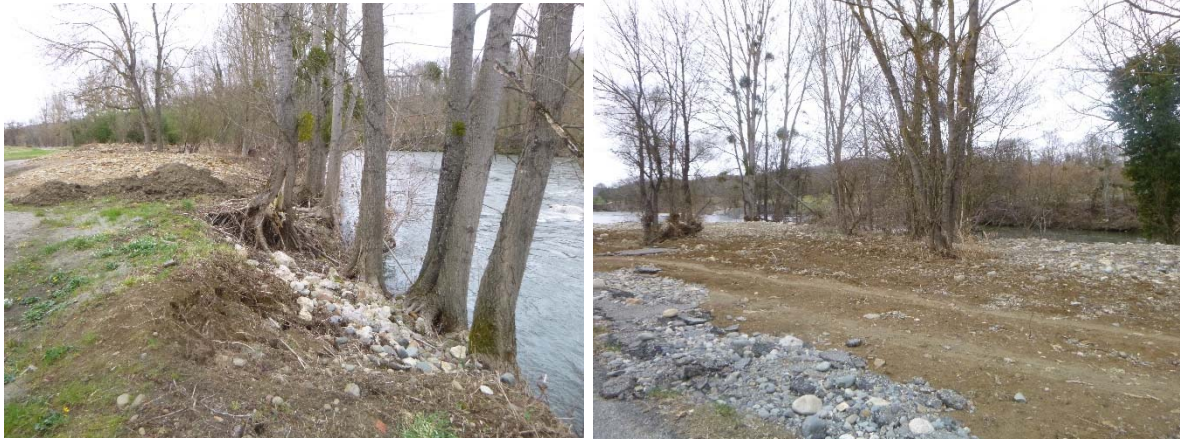
Illustration 44. Dégâts post-crue de janvier 2022 - secteur 1 (SSV ©)
