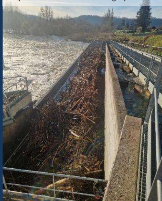
La passe à bassins de Mauzac Barrage après la crue
