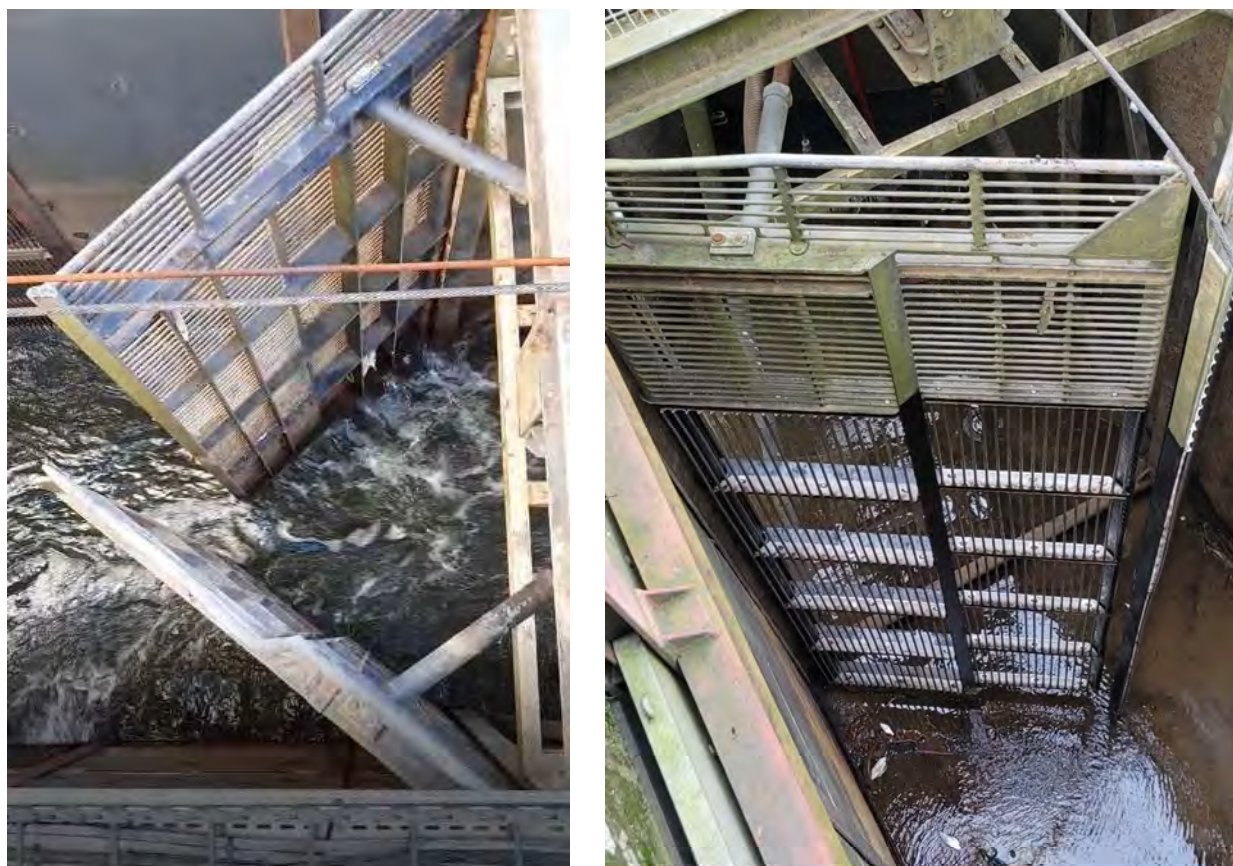
Photo 10 : photos du barreaudage des portes antiretour de la nasse du piège de l'ascenseur de Golfech avant modification (photo de gauche) et après modification (photo de droite)
