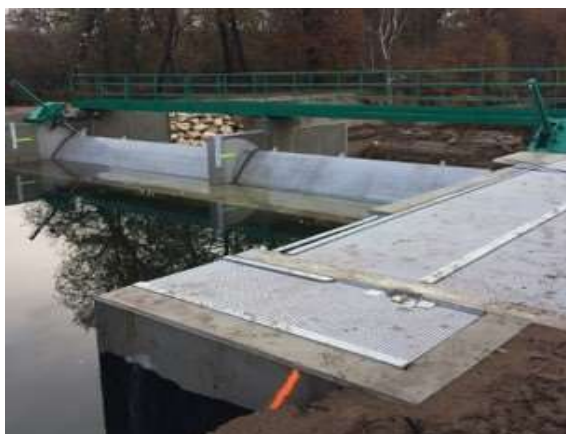
Figure 14 : Photo de l'écluse (vannes fermées), au premier plan le coffret béton dans lequel la caméra est installée
