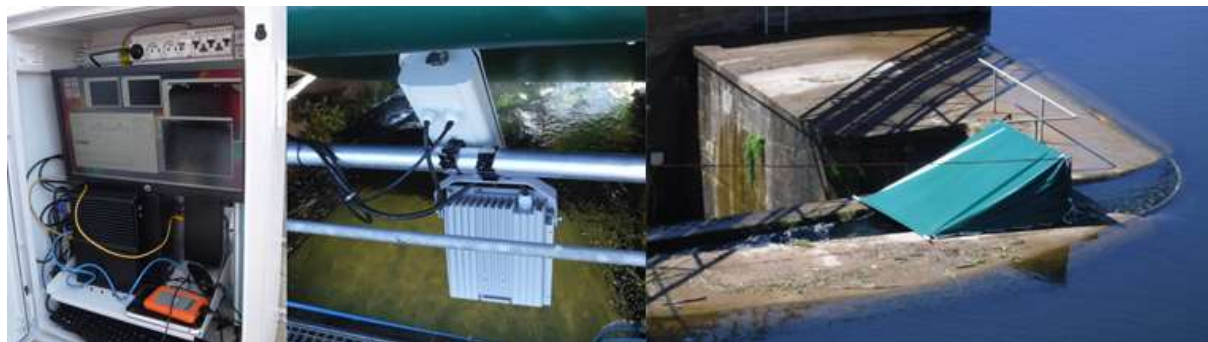
Photo 18 : Le système vidéo de la passe à ralentisseurs du barrage de Mauzac.
