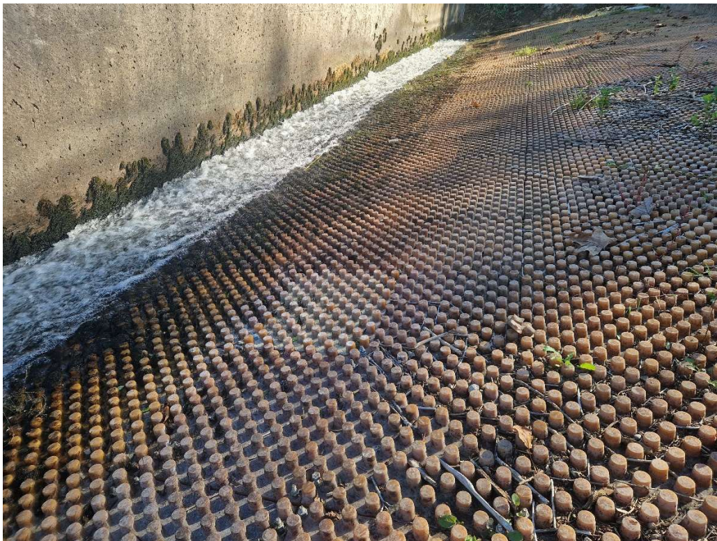
Figure 9 : éléments manquants de la passe à anguille de Bergerac le 13/06/24, et leurs remplacements le 13 octobre 2025
