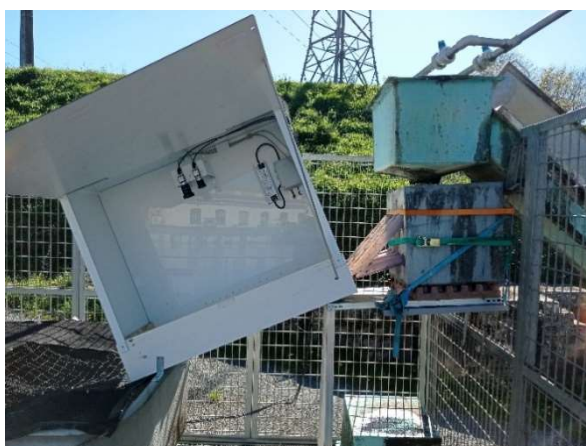
Photo 12 : Système de comptage automatique HIZKIA installé sur le site de Tuilières
