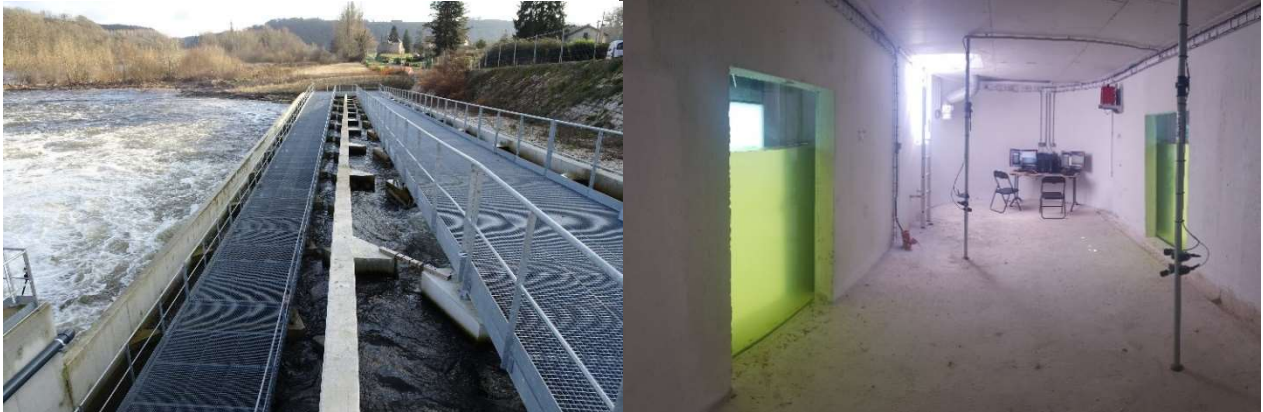
Photo 14 : vue générale de la passe à poissons du barrage de Mauzac et vue de l'intérieur du local de comptage
